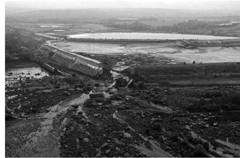
A X. tározó északnyugati sarkának átszakadása (20 m szélességben és 10 m magasságban)
