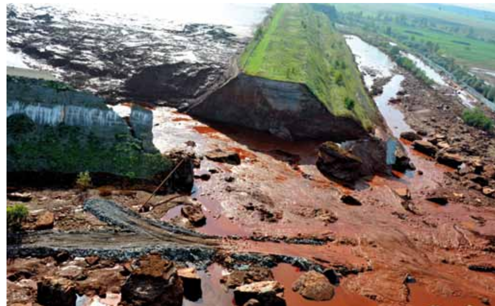
A X. tározó északnyugati sarkának átszakadása (20 m szélességben és 10 m magasságban)
