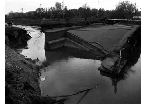
A X. tározó északnyugati sarkából kiszakadt rész
